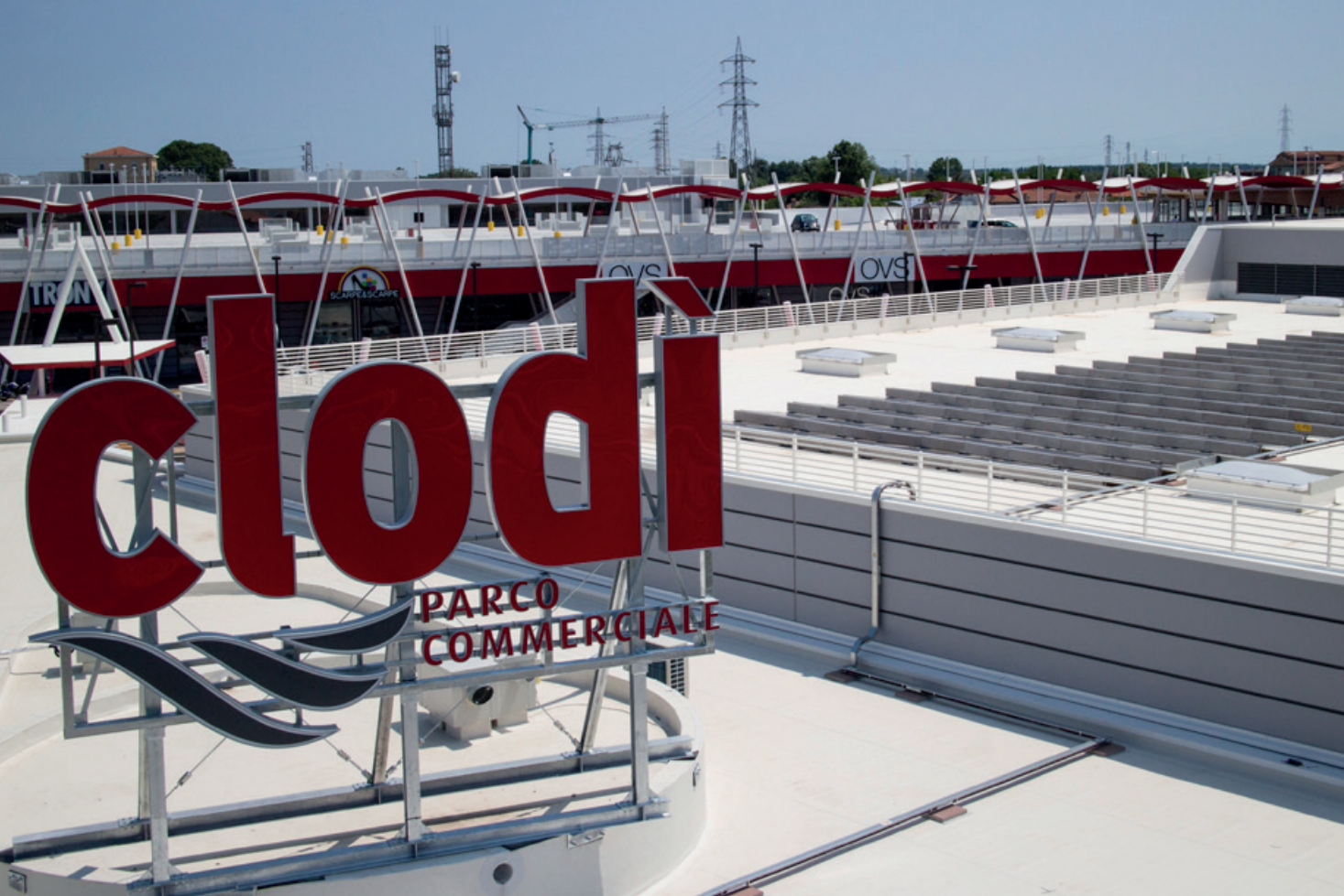
Chioggia (VE) Clodi Impianto fotovoltaico
